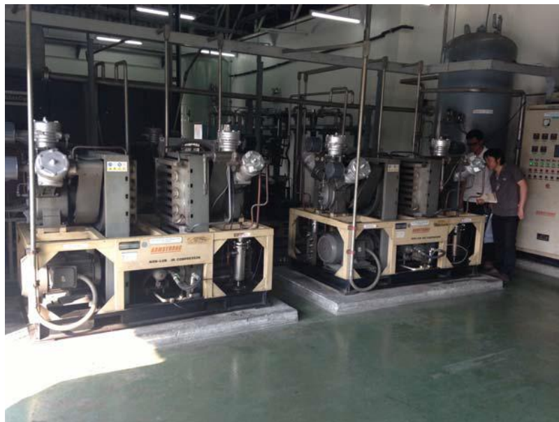
รูปที่ 4 การวางตำแหน่งเครื่องอัดอากาศแบบลูกสูบชนิดความดันสูงเรียงเป็นกลุ่ม
