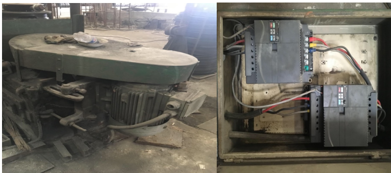
รูปที่ 10 มาตรการเปลี่ยนมอเตอร์ประสิทธิภาพสูง และติดตั้งอุปกรณ์ลดความเร็วรอบมอเตอร์ (Inverter)
