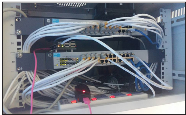
ภาพที่ 13 การติดตั้งเครื่องแม่ข่ายในตู้อุปกรณ์เครือข่าย ในห้องปฏิบัติการ
